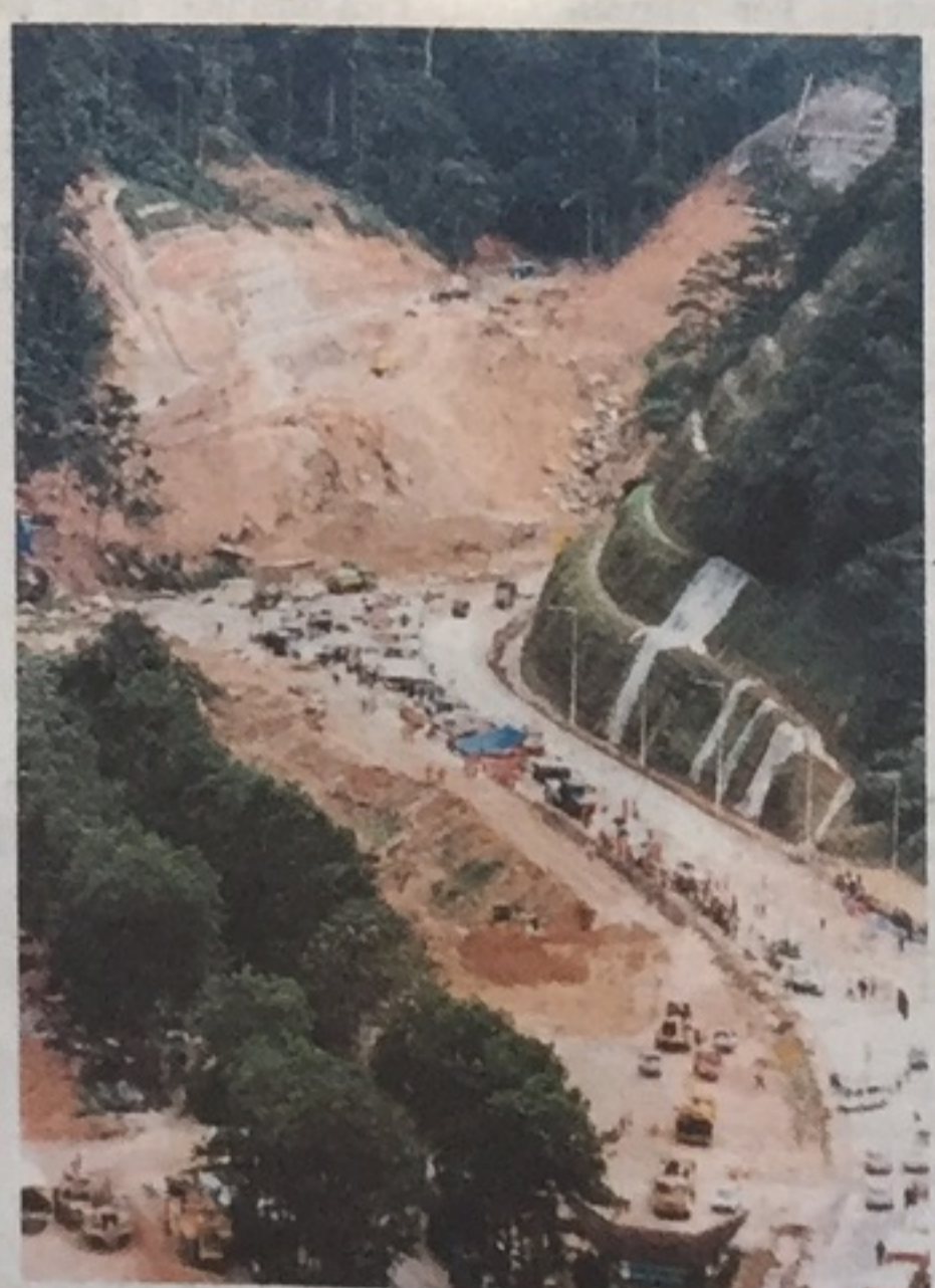
Kejadian tanah runtuh di jalan susur ke Genting Sempah yang berlaku pada 30 Jun 1995.
