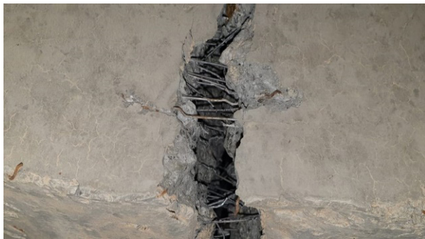
RAJAH 8. Lebar keretakan pada sampel rasuk yang menggunakan 40kg/m 3 gentian keluli
