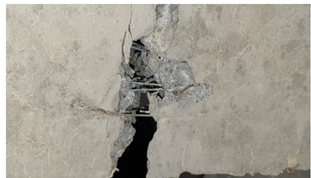
RAJAH 7. Lebar keretakan pada sampel rasuk yang menggunakan 30kg/m 3 gentian keluli
