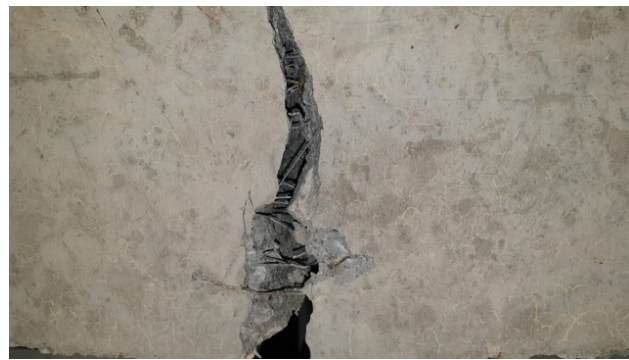
RAJAH 6. Lebar keretakan pada sampel rasuk yang menggunakan 20kg/m 3 gentian keluli
